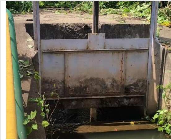
雨水池限位挡板（排口）
