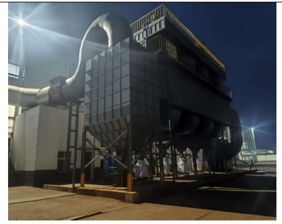
铸轧除尘设施
