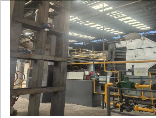
车间内可燃气体泄露报警器
